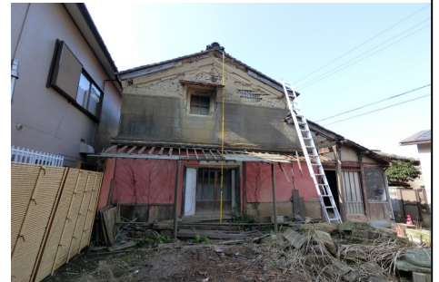
着工前の傷んだままの外壁
